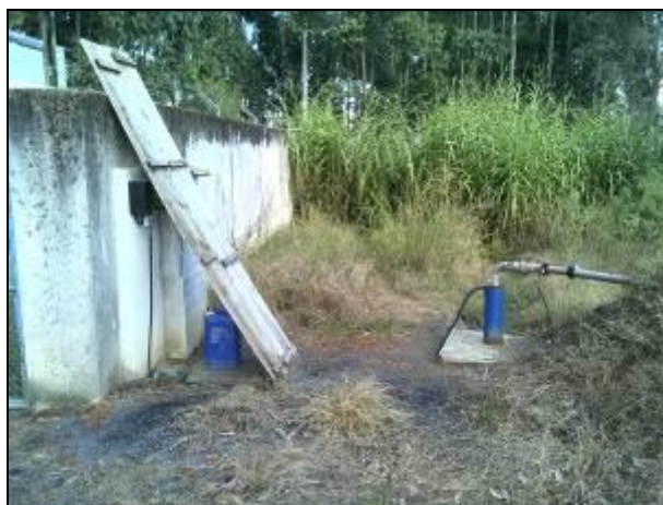
Figura 10: Captação subterrânea sem isolamento.
