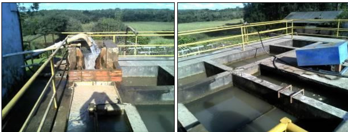
Figura 6: Unidades de tratamento da ETA.
