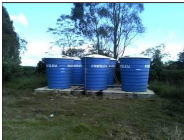
Figura 9: Reservatórios R02 e R03.
