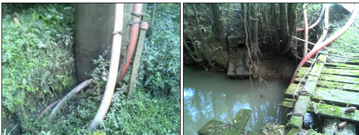
Figura 4: Condições operacionais inadequadas de captação de água bruta.
