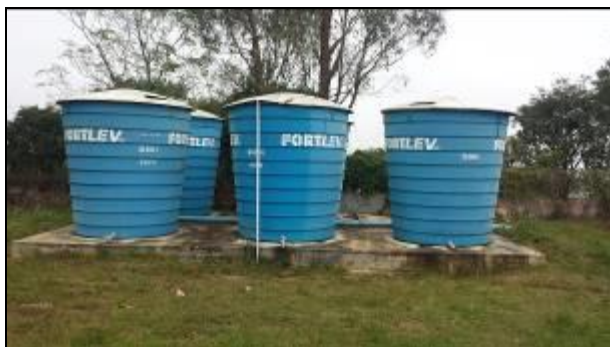
Figura 5: Imagem dos Reservatórios que recebem água tratada da Casa de Química do município de Papanduva.
